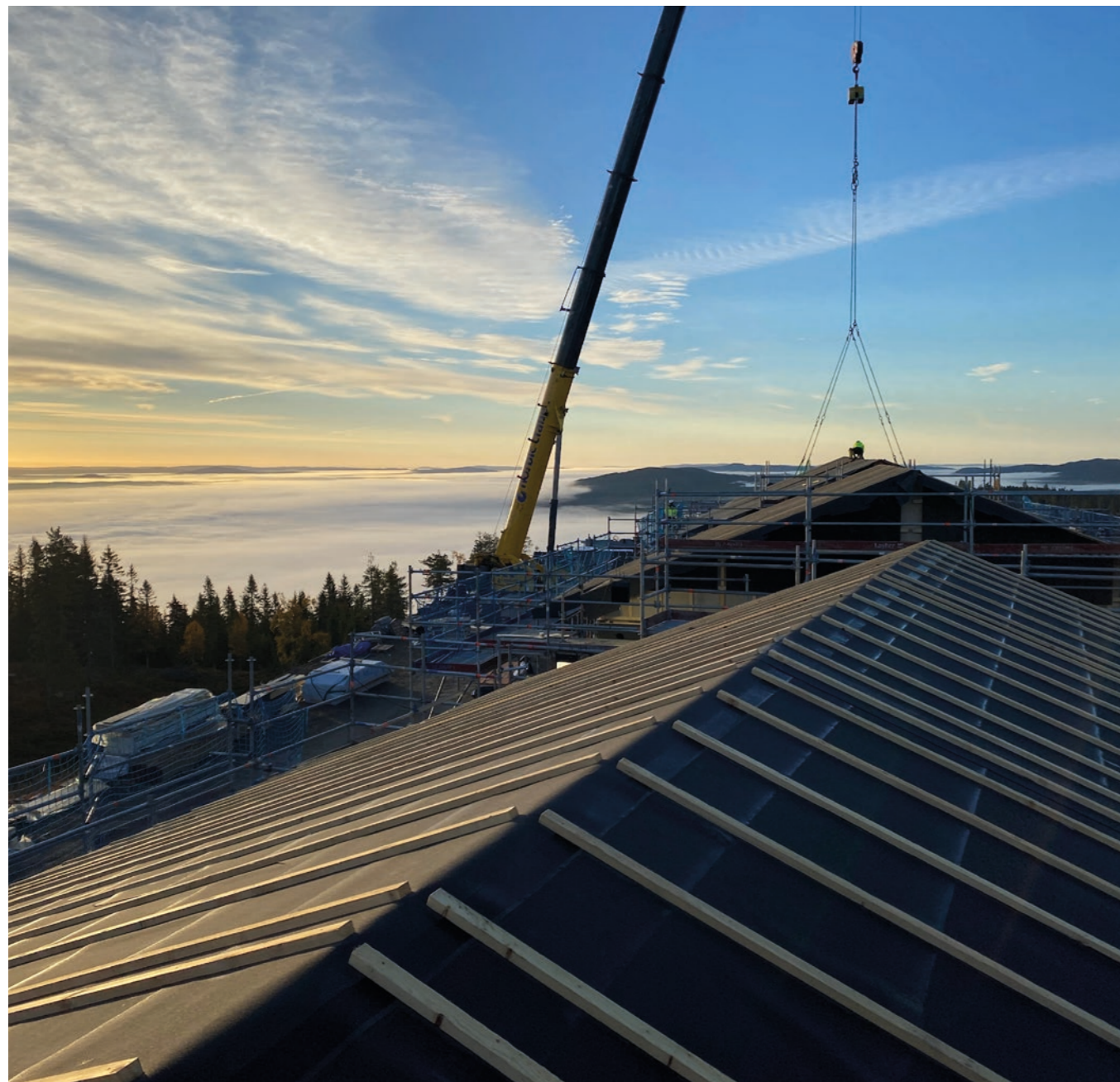
På Branäsberget i norra Värmland har Moelven Byggmodul AB levererat 48 lägenheter. Foto: Andreas Hylthén
